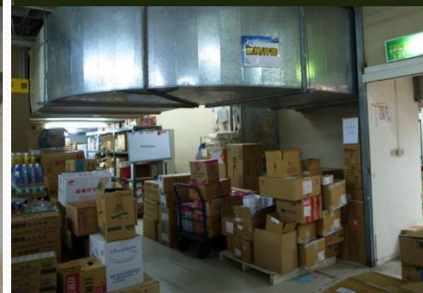
4. 老舊管線影響空間使用
